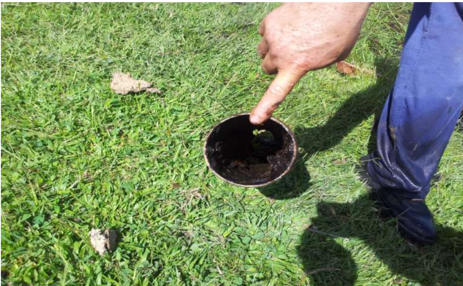
Figura 5 – Canalização (detalhe da material depositado nas paredes da canalização) que leva a água bruta até a ETA - Janeiro/2013.
